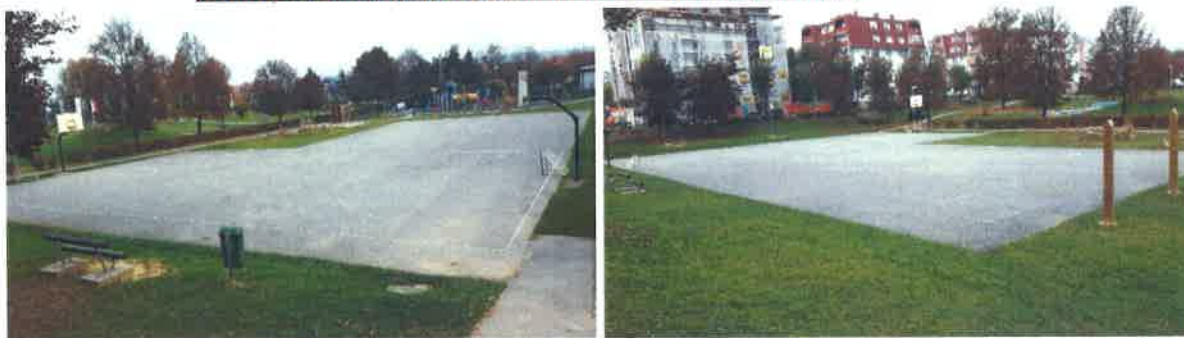
Slika 7: Obstoječa dotrajana večnamenska asfaltna površina
